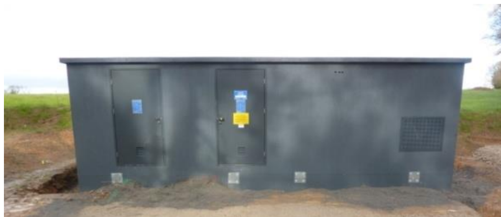
Figure 27 : Exemple du poste de livraison installé (crédit photo Quenea)
